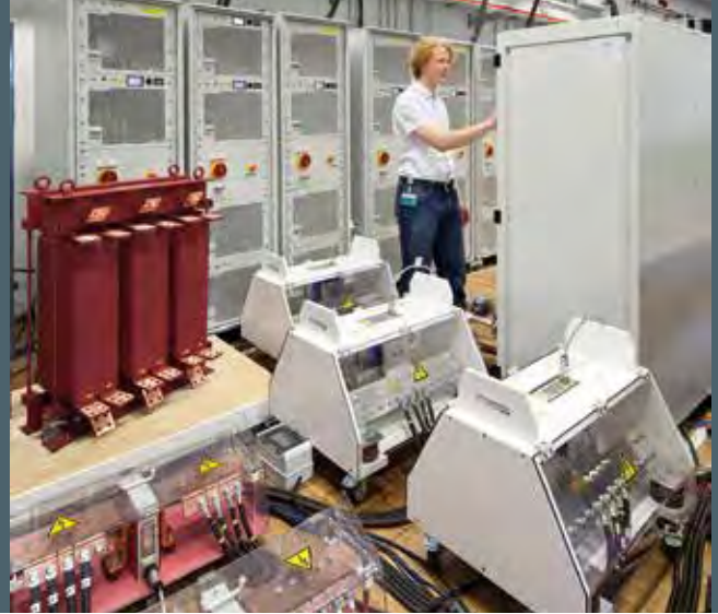
Das Wechselrichterlabor des Fraunhofer ISE bietet alle notwendigen Einrichtungen für die Prüfung von Zentralwechselrichtern bis zu einer Leistung von 1 MW nach diversen Netzeinspeise-Richtlinien.
