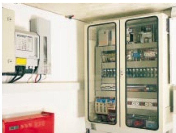
Abb. 4: Die Steuerung der gesamten Hausenergieversorgung.
