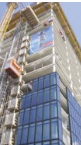
Abb. 2: Der Messturm in Basel, Schweiz. Beim höchsten Haus der Schweiz wird die Abluft aus dem Raum durch den Fassadenzwischenraum abgesaugt. Sie kühlt damit den Fassadenzwischenraum und den Sonnenschutz, der von der Abluft umspült wird. Auf dem Bild zu sehen ist die Anbringung der Fassadenelemente.
