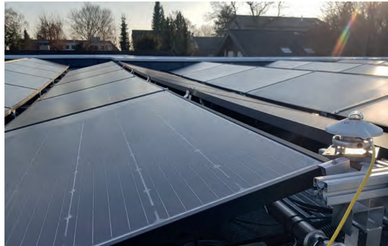
Demonstrationsanlage mit PVT-Kollektorfeld.
