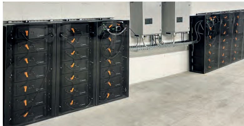
Batteriespeicher in der Mehrfachnutzung: Zwischenspeicherung von Solarstrom zur Optimierung des Eigenverbrauchs sowie zur Kappung von Lastspitzen.
