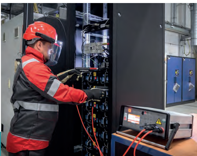
Manuelle Vermessung eines Batteriespeichers am Fraunhofer ISE.
