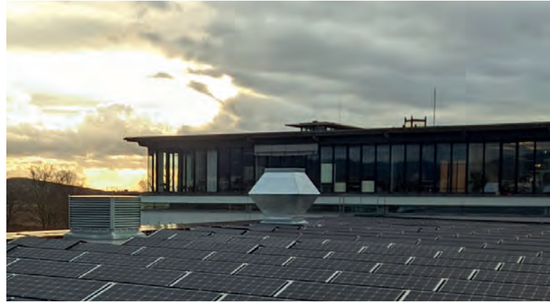
PV-Anlage auf dem Dach des neuen Zentrums für elektrische Energiespeicher im Freiburger Industriegebiet Haid.
